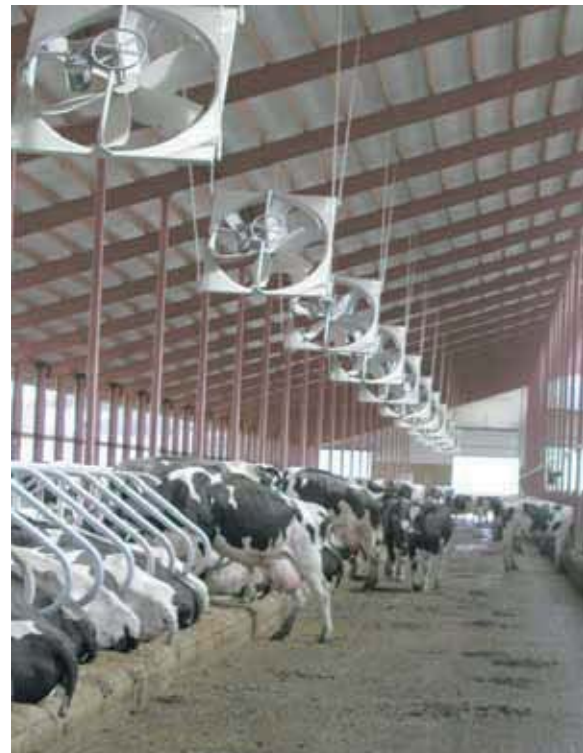
Umluftventilatoren in den USA Abb. 2
