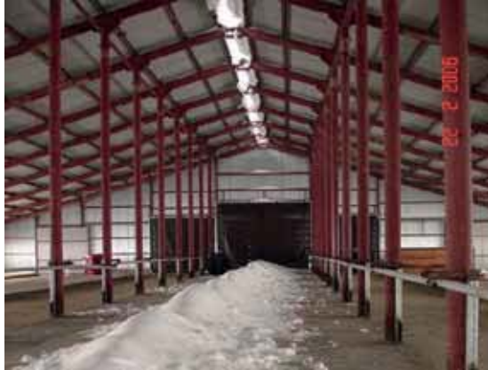
Niederschlag durch offenen First ohne Windabweiser trotz Abdeckung. Abb. 4
